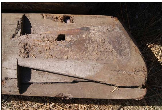
Afb. 27 Uiteinde van de bovenste dekbalk aan de noordkant. Aan de bovenzijde is een inkeping voor de overstekbalk aanwezig.
