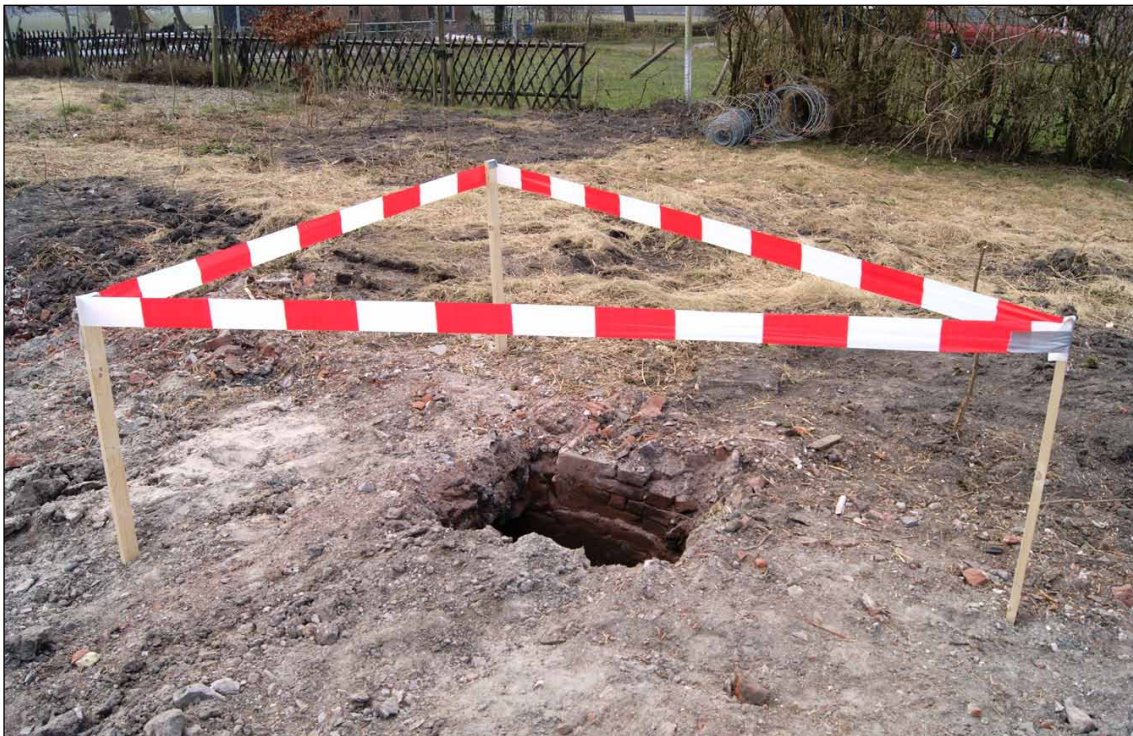
Afb. 74 Tijdens een opname na de sloop van de stolpen lag de waterkelder nog open.
