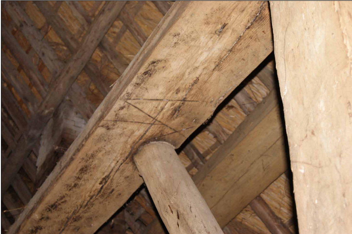
Afb. 36 Merk op de onderzijde van de onderste dekbalk aan de westkant.
