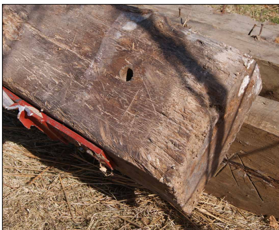
Afb. 31 Een rond gat in de onderzijde van een vierkantstijl.
