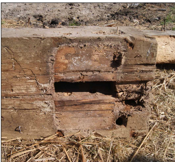
Afb. 22 Rechthoekig gat in de onderzijde van een onderste dekbalk. Hierin werd de pen van een vierkantstijl ingelaten.
