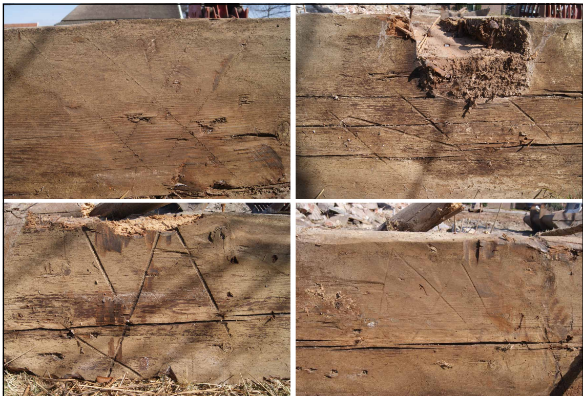
Afb. 35 Vier merken op de onderste dekbalk aan de oostkant.
