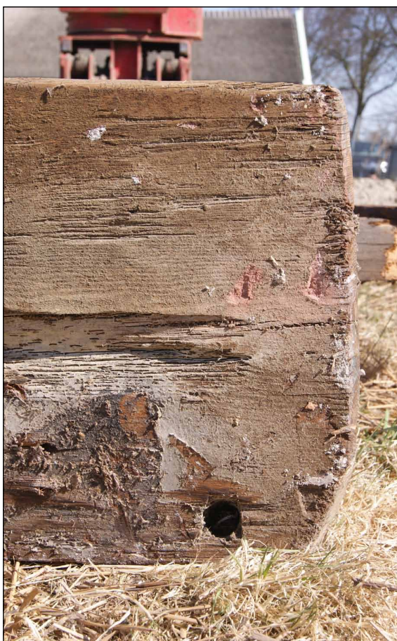
Afb. 32 Een gat in de bovenste dekbalk aan de zuidkant.
